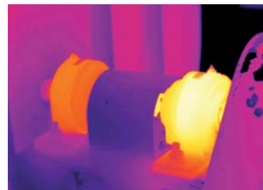
Surchauffe d'un chapeau de palier
